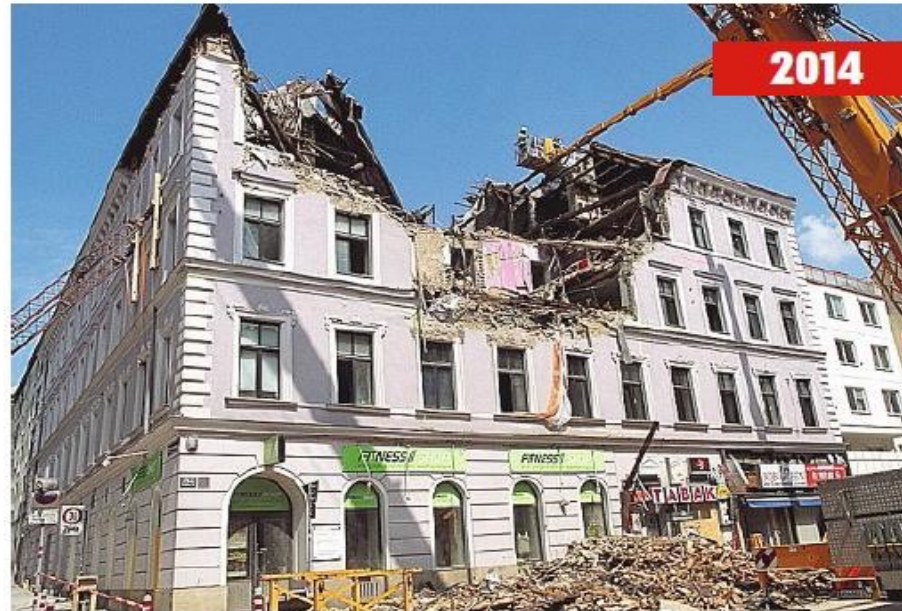
⊕ Die Gasexplosion in der Mariahilfer Straße 182 kostete ein Menschenleben. Die Einkaufsstraße war tagelang gesperrt.
