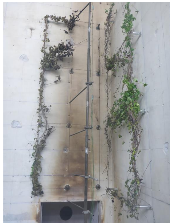
Abbildung 7-17: Fassadenbegrünung nach der Prüfung
